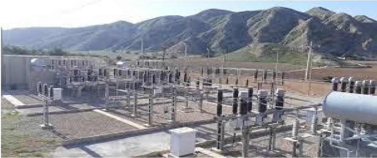
پست برق ایستگاه شهروز شهر شیراز
